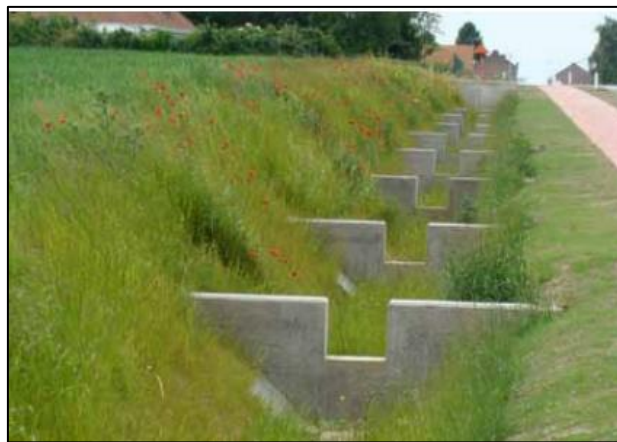
Figuur 84: Gracht met stuwconstructies (Bron: Vlaamse Overheid; [66])
